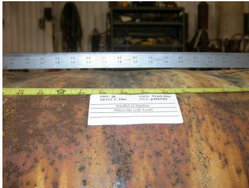
Figure 3-18. Defects D10, D11, D12 (p28dTH1)
