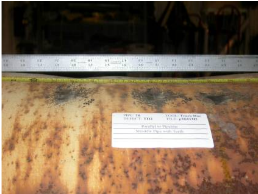
Figure 3-21. Defects D13, D14, D15 (p28dTH2)
