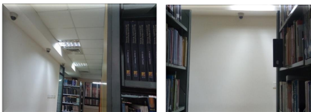
Fig MIT Library: CCTV cameras in book stack
